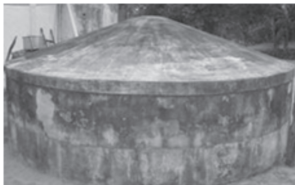
Figura 1 Cisternas tipo placas utilizadas para armazenar água de captação pluvial
